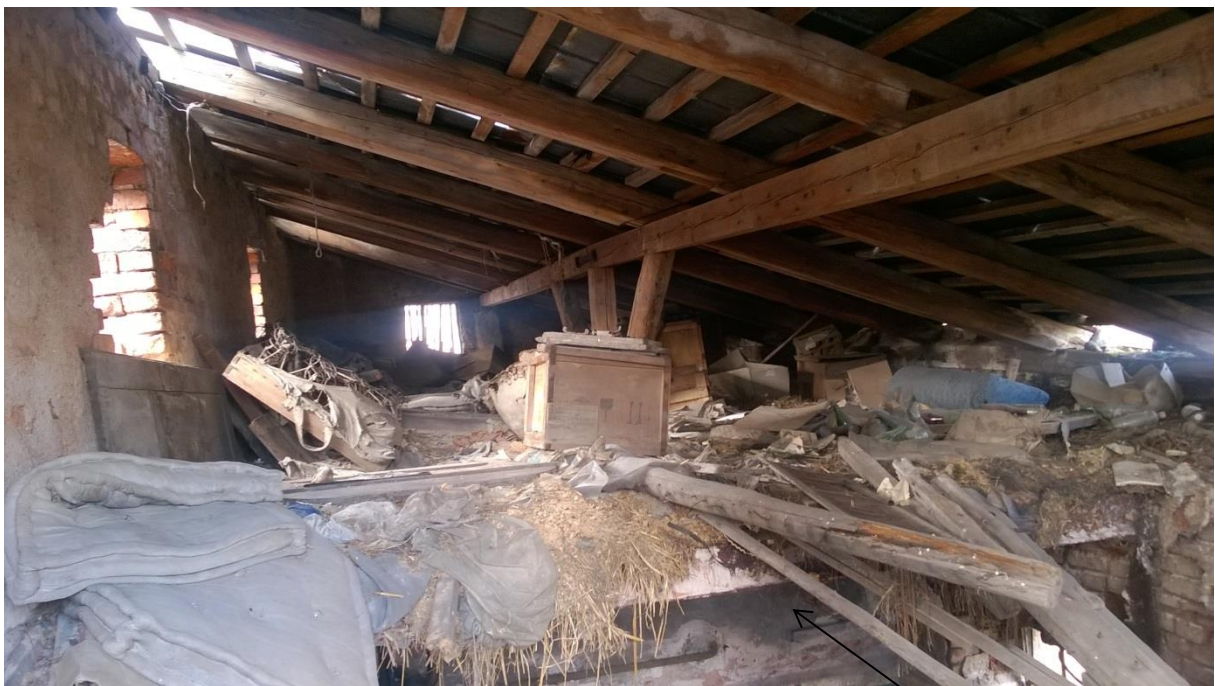
pomieszczenie strychowe z widocznym zawalonym stropem nad parterem
